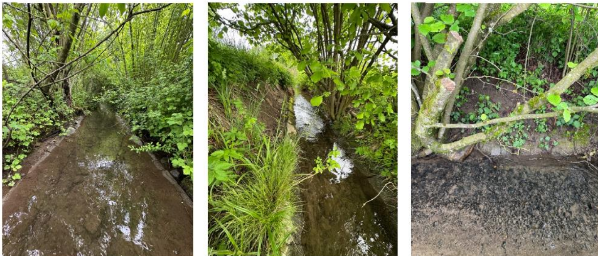
Abb. 2: Uferverbau mit Moellonsteinen auf gespreizter Rundholzlage (Links, Mitte) und Sohlenkolmation (Rechts)
