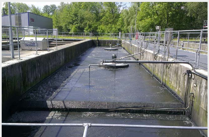
Fig. 4 PAK-Dosierung in die Nachbelüftungszone der Biologiestrasse 3 Franz. Legende
