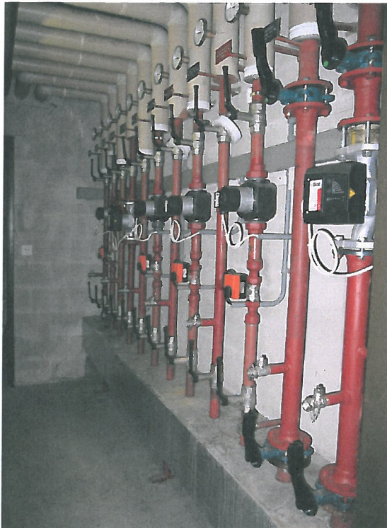
Heizungsunterverteilung im 2. OG
