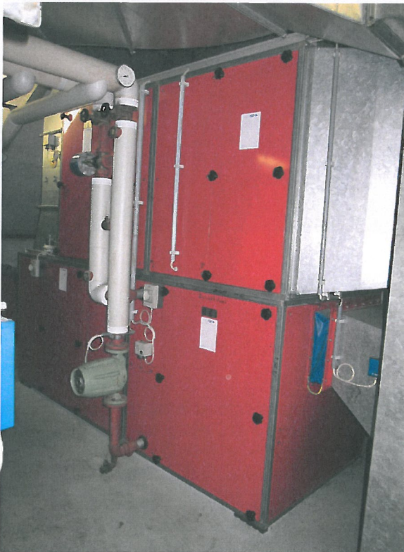
Lüftungsgerät Saal ohne WRG
