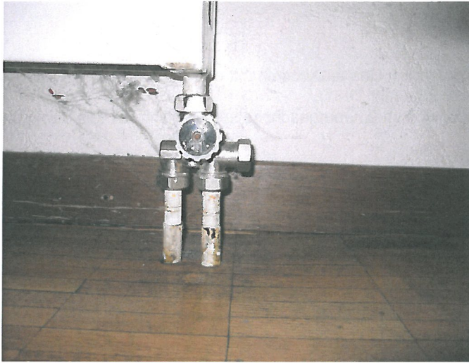
Heizkörperventil mit Handrad
